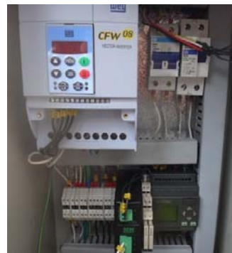
Fig. 5. Tablero de PLC y reguladores
