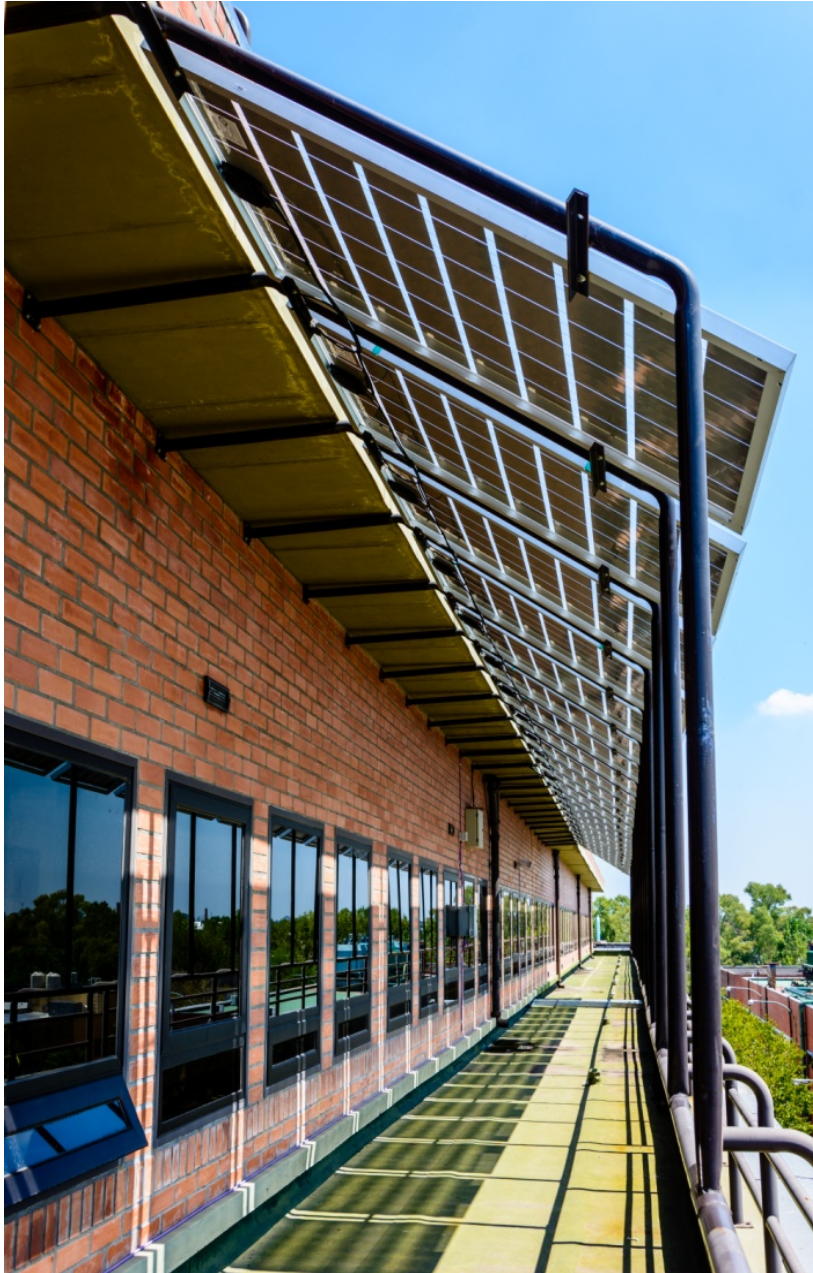
Figura A. Pérgola FV en el Edificio Tandar del Centro Atómico Constituyentes (CNEA).
