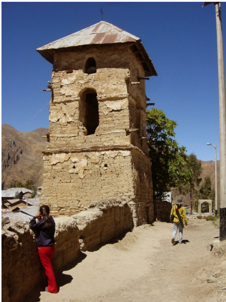
Fig. 10. Campanario exento de la iglesia colonial de Rapaz, antes de su tratamiento de conservación (Foto del autor)
