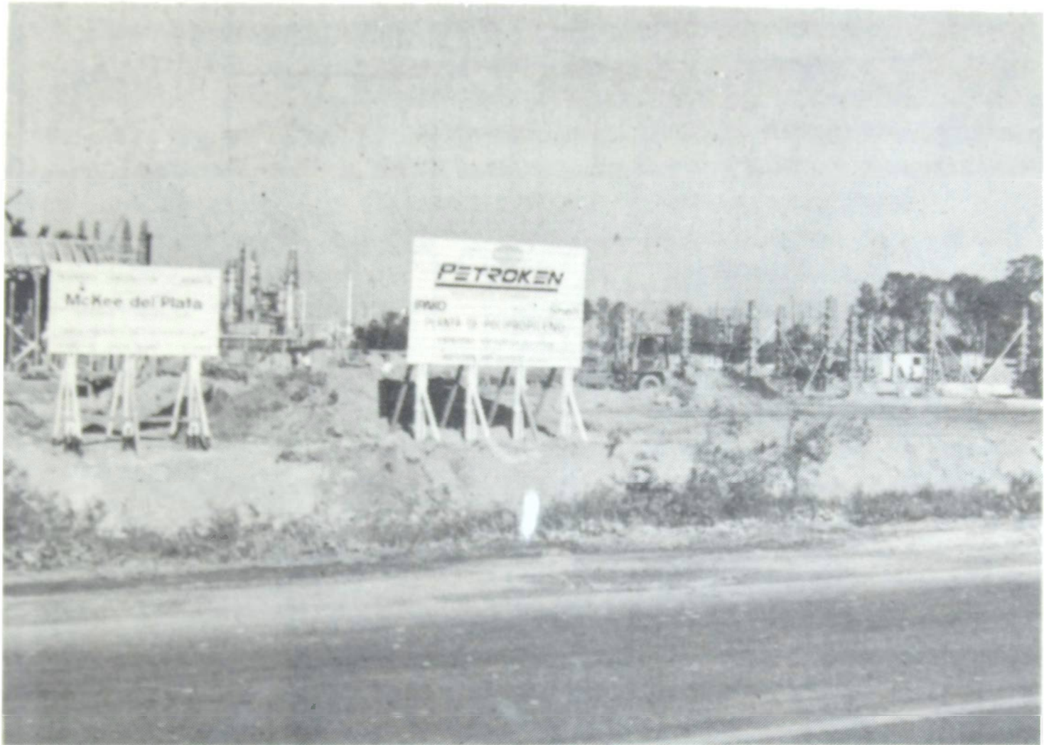
Imagen 4: La elevación del nivel del terreno en la Planicie Costera - incluso sobre las cotas de las Rutas Provinciales- produce alteraciones en los flujos laterales superficiales y subterráneos si no es acompañado de canales de desagüe con capacidad de drenaje suficiente. En la imagen, "Petroken" y un pequeño canal desagüe sobre el camino entre La Plata y Ensenada.
