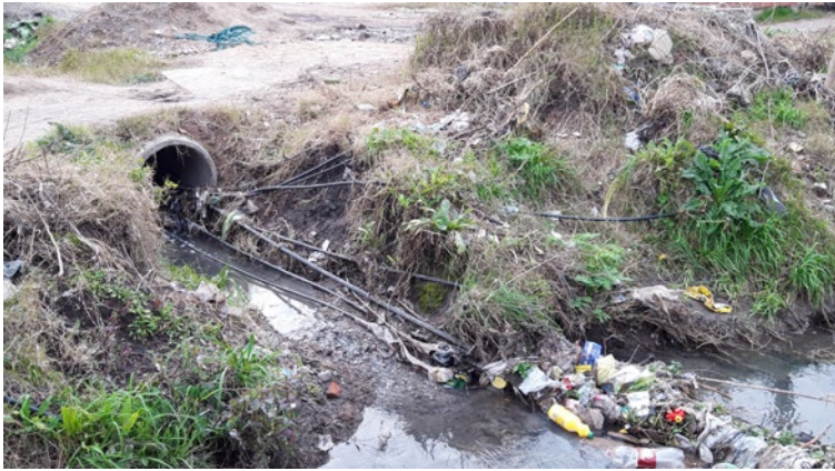
Figuras 37, 38 y 39. Conexiones de agua precarias a cielo abierto en el barrio Puente de Fierro. Fotos: Tomás Canevari
