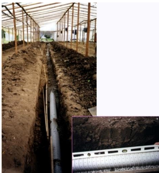
Imagen 19. Drenes instalados en el techo del horizonte Btss cubiertos con piedra granítica y detalle del dren con uso de nivel para mantener pendiente
