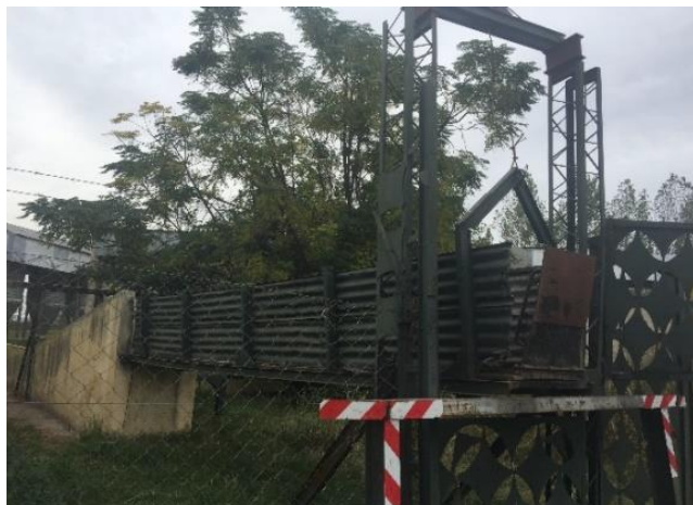
Foto 2. Cargador con alambrado perimetral.
