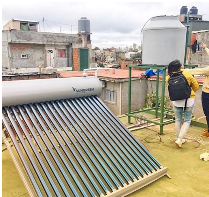
FIGURA 2.:TERMOTANQUE SOLAR INSTALADO EN EL COMEDOR EN-HACCORE: PRECALIENTA EL AGUA PARA COCCIÓN, BAJANDO LA DEMANDA DEL GAS DE GARRAJA
