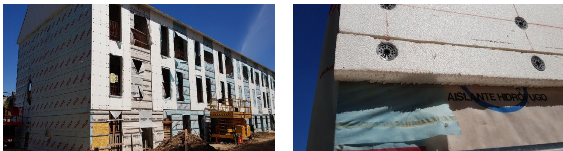
FIGURA 12. NUEVAS VIVIENDAS DE BARRIO 31: MUROS EXTERIORES DE STEEL FRAME (AISLADO CON LANA DE VIDRIO Y POLIESTIRENO EXPANDIDO)
