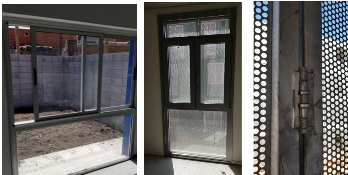
FIGURA 14. NUEVAS VIVIENDAS DE BARRIO 31: VENTANAS DE DVH CON PROTECCIÓN SOLAR, AUMENTAN LA SEGURIDAD, LA AISLACIÓN TÉRMICA Y EL CONTROL DE LA INSOLACIÓN.
