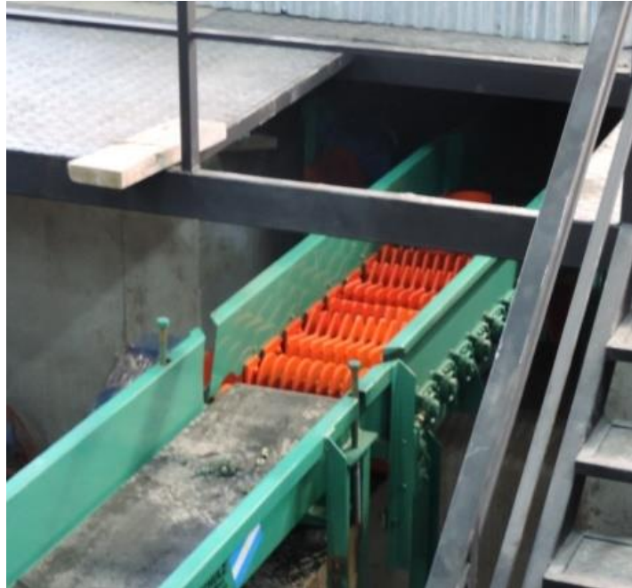
Figura 3.32. Clasificador de residuos del aserradero-CTM. Fuente propia (2019).
