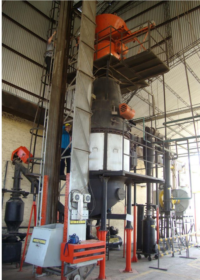
Figura 6.34. Gasificador de madera de lecho fijo downdraft (Presidencia de La Plaza, Chaco). Fuente: propia (viaje de estudio Ing. Ftal., 2015).
