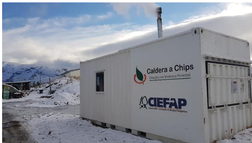
Figura 1.21. Caldera a base de chips (Bariloche, Rio Negro). Fuente: CIEFAP (2021) 9 .
