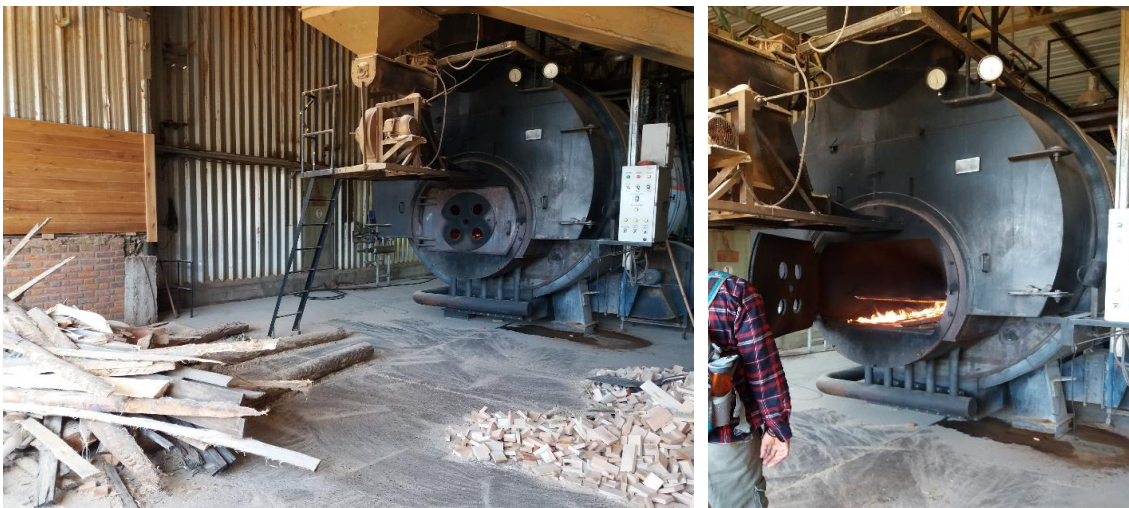
Figura 6.22. Caldera de biomasa alimentada con residuos foresto-industriales (Entre Ríos). Fuente: propia (viaje de estudio Ing. Ftal, 2019).
