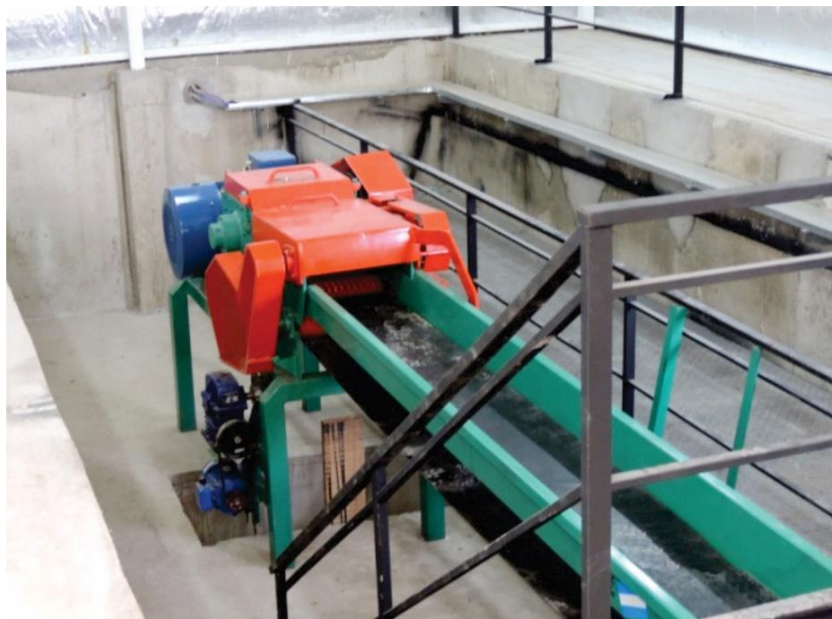
Figura 3.34. Cinta transportadora de productos secundarios y astilladora puesta en servicio-CTM. Fuente: propia (2019).
