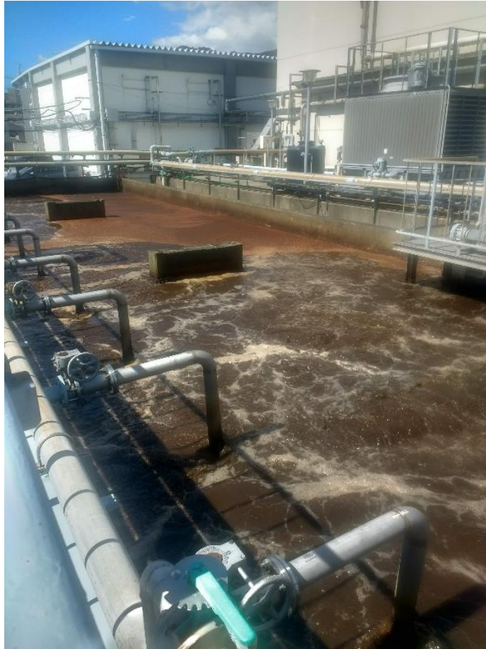
Figura 6.4. Planta de tratamiento de efluentes industriales (Buenos Aires). Fuente: propia (2019).
