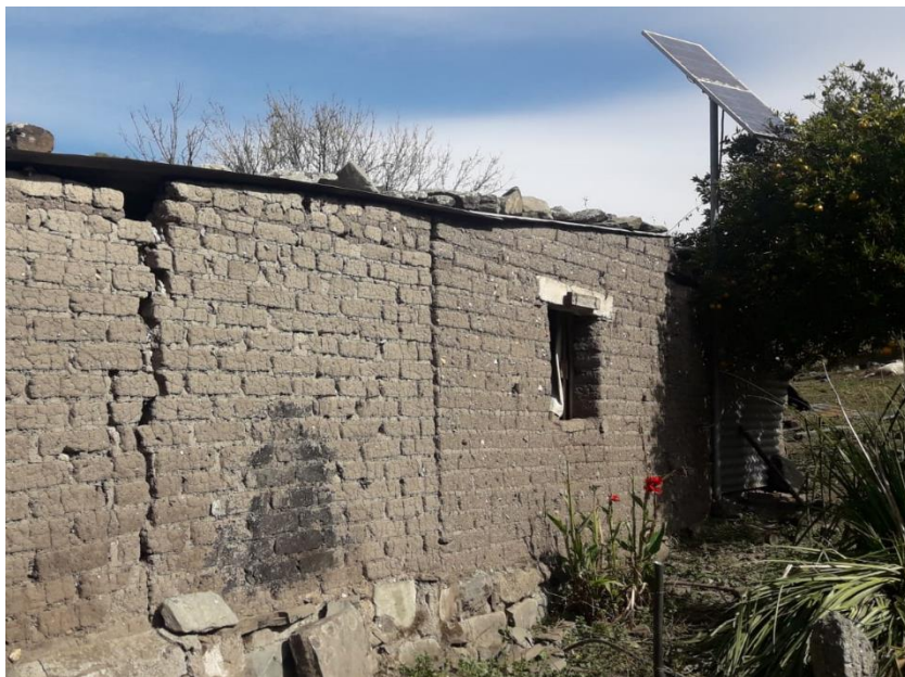
Figura 2. Daños en una vivienda.
