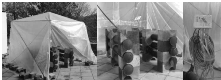
Figura 85. Vista del invernadero con sistema MAC 2 “tubo simple” y cableado de sensores.
