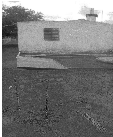
Figura 2: El mismo nicho una vez instalada la Planta con la parte superior de ésta en el fondo.
