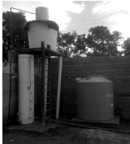
Figura 5: Planta de Tratamiento
