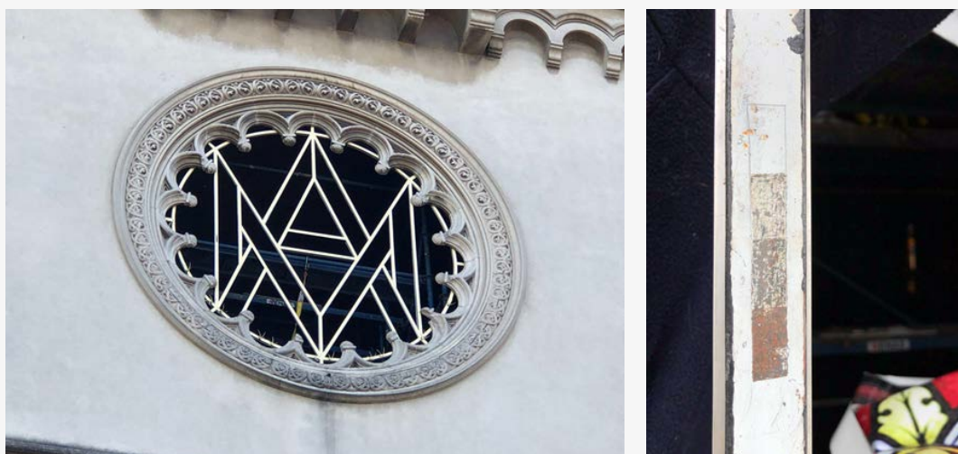
Desmontaje de los vidrios de protección del Rosetón. Acondicionamiento de la estructura de hierro de sostén, pintado de la carpintería. Para llegar al color con el que se pintó la carpintería se realizó previamente un cateo sobre la estructura para determinar el color original de la misma. Parroquia-Santuario Medalla Milagrosa.
