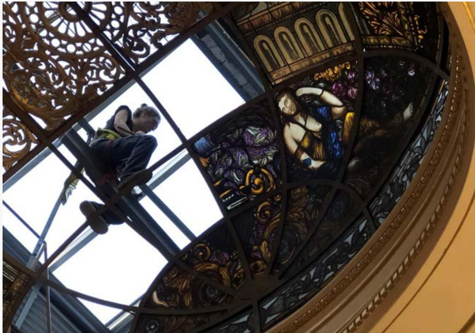
Imagen superior del desmontaje de los paneles de vitral, que conforman la Cúpula de la Confitería La Ideal, CABA (2019). Desmontaje de los paneles medios.
