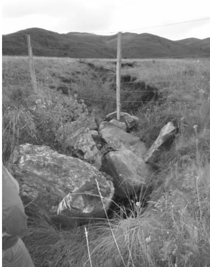
Figura 7.49. Obra incorrecta para corrección de cárcavas
