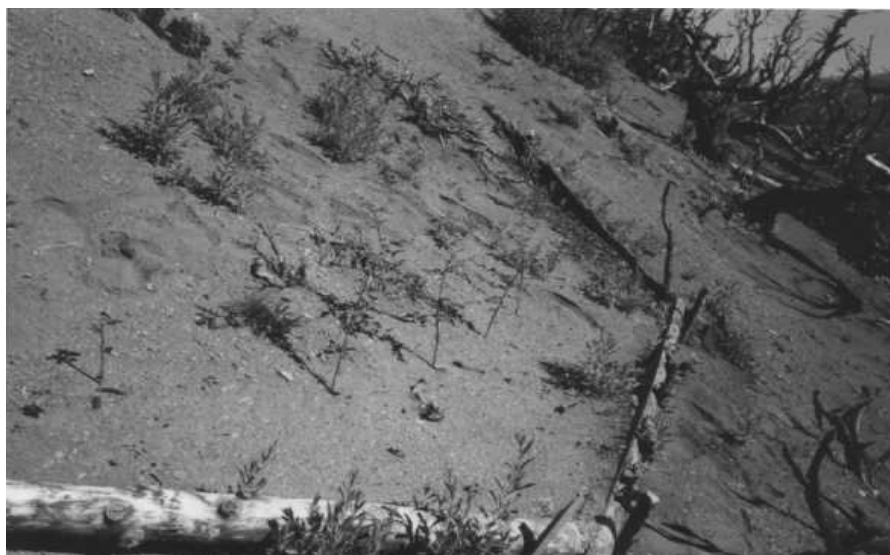
Figura 7.15. Estabilización de laderas con estructura de postes de madera en medialuna y plantación de especies forestales nativas.
