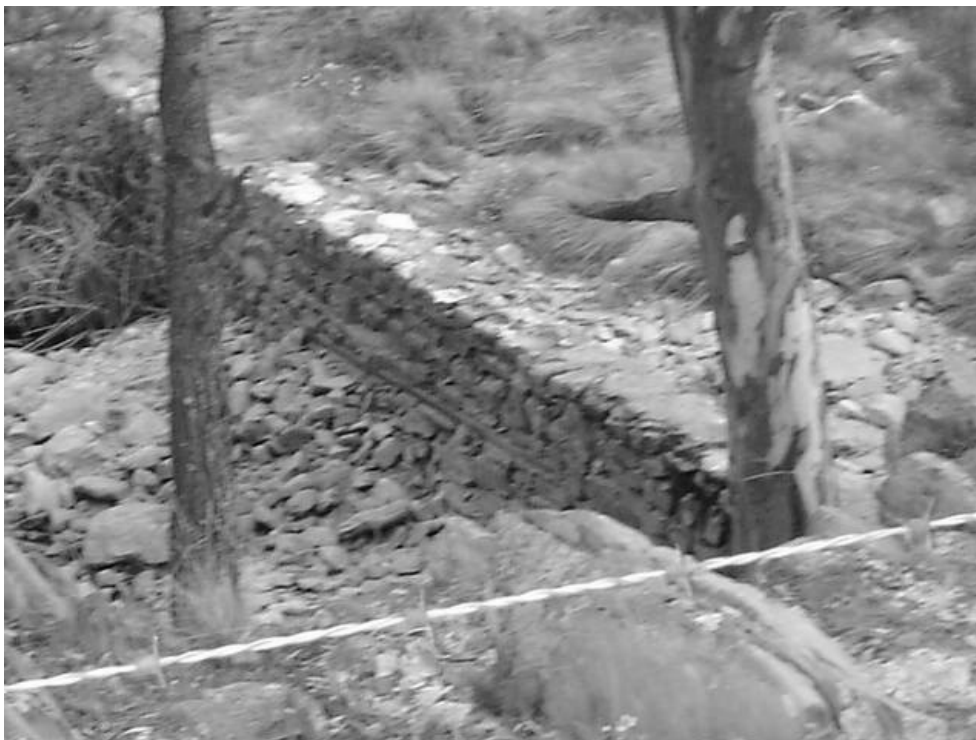
Figura 7.36. Detalle de un dique de piedra colmatado sin medidas de mantenimiento.
