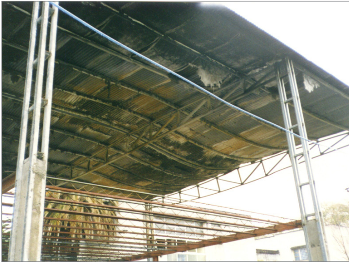
► El día después del incendio.
