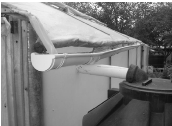
Fig. 3. Estructura colectora de agua de lluvia desde el techo del invernadero escolar
