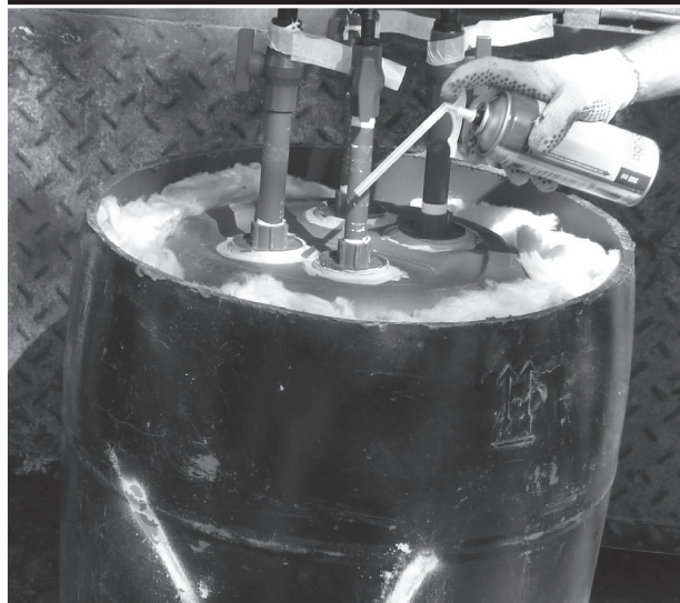
C. Tanque de acumulación aislado.
