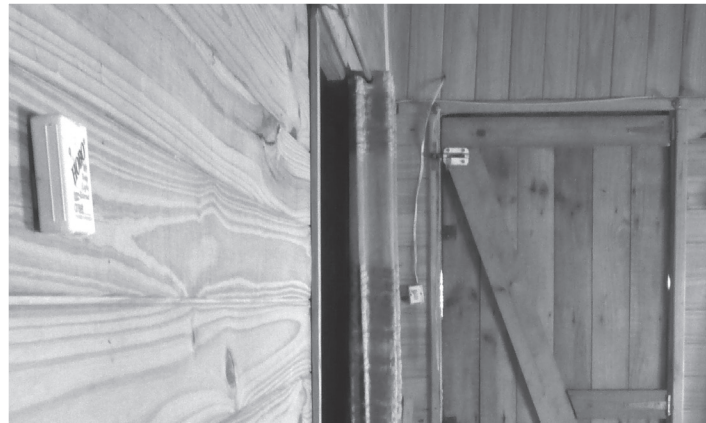
Fotos con los equipos de medición instalados en las viviendas
