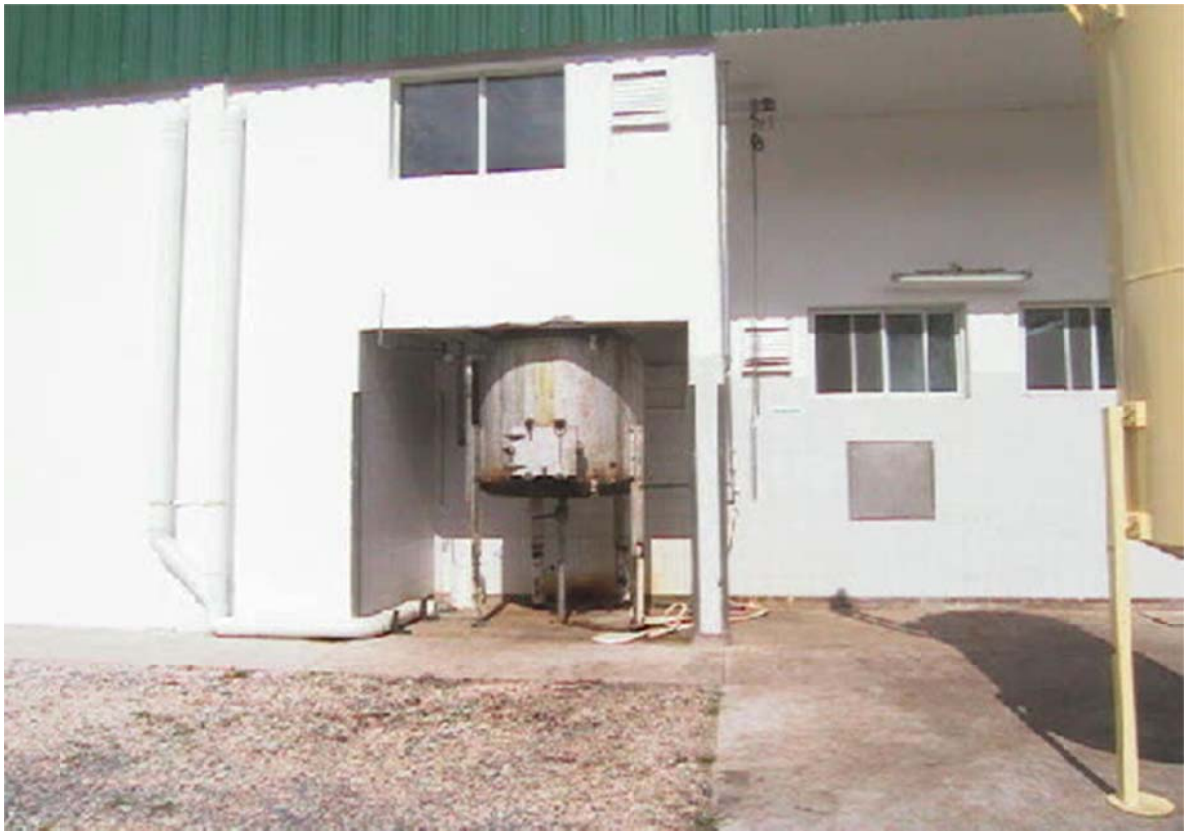
Foto 21. Se puede observar el digestor en el cual se desnaturalizan los animales muertos o los que han sido decomisados en la revisión en la sala de emergencia. En el costado derecho se observa el guinche con el cual se eleva el animal que debe ser introducido en el mismo.
