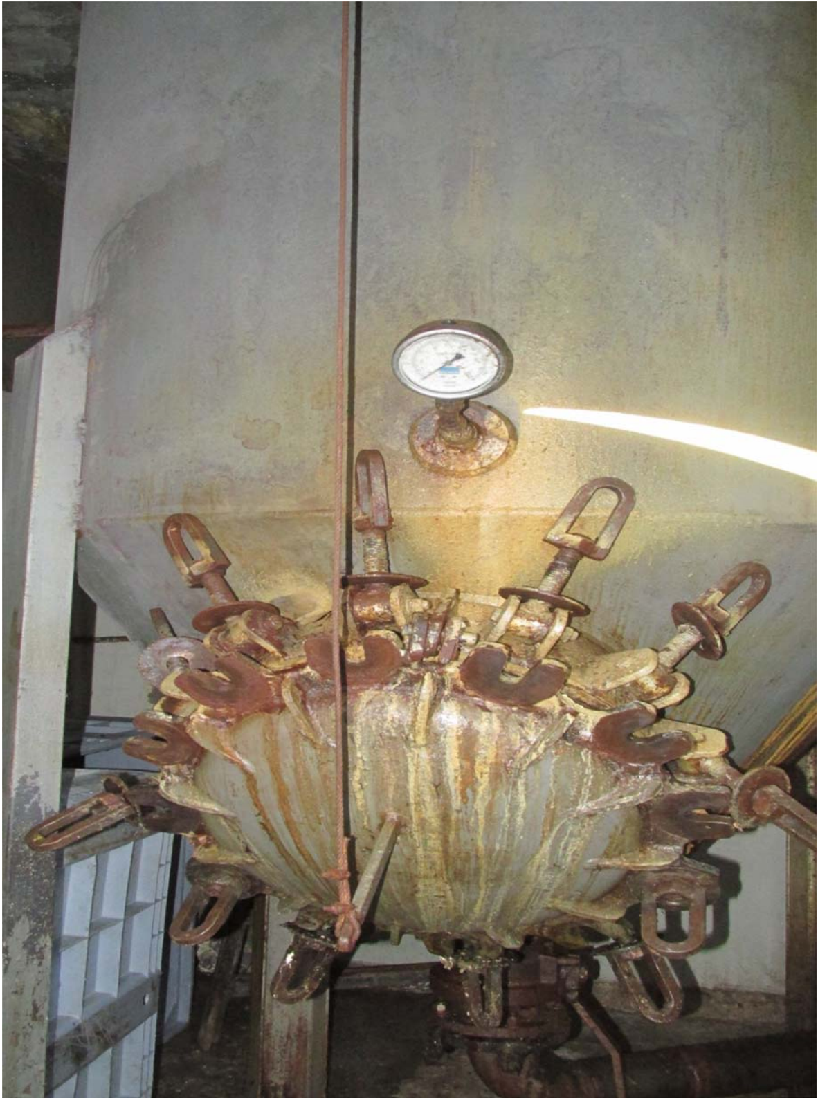
Foto 20. Vista parcial del digestor en donde se observa el reloj de la temperatura (termómetro) y la tapa cerrada parcialmente con los tornillos.
